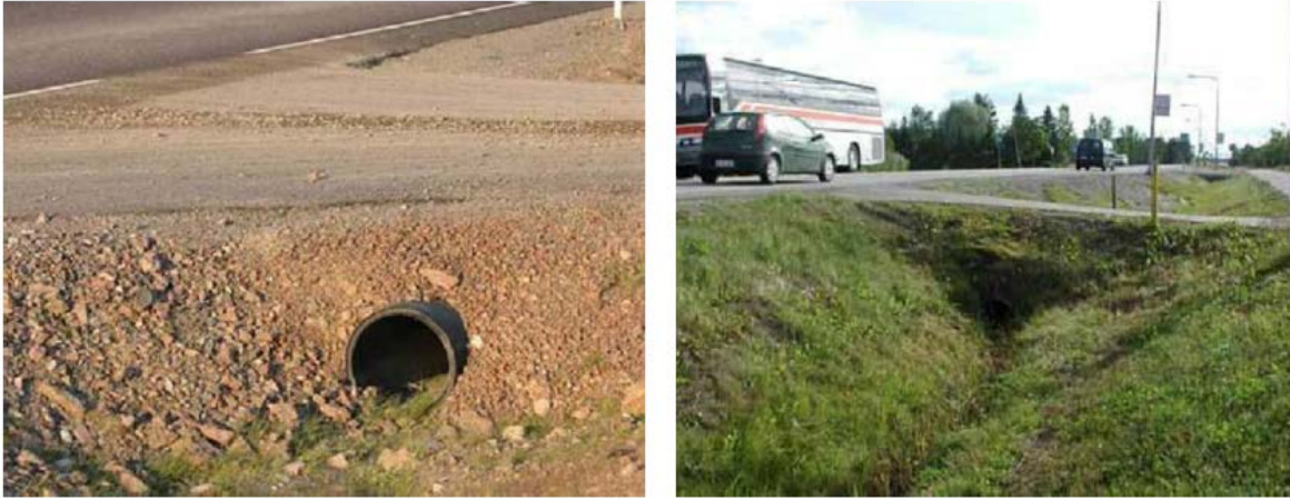
Şekil 55: Tehlikeli drenaj yapısı örnekleri (Kaynak: [A.2])
